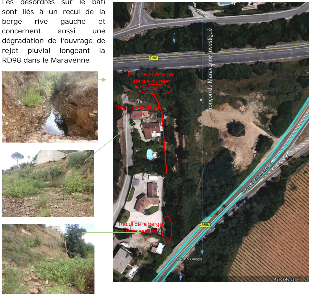
Figure 1 : Principaux désordres constatés
