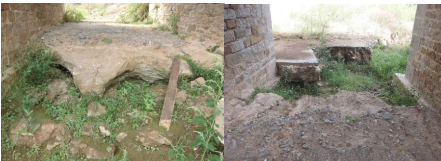
Figure 2 : Désordres autour la pile de l'ancien pont
